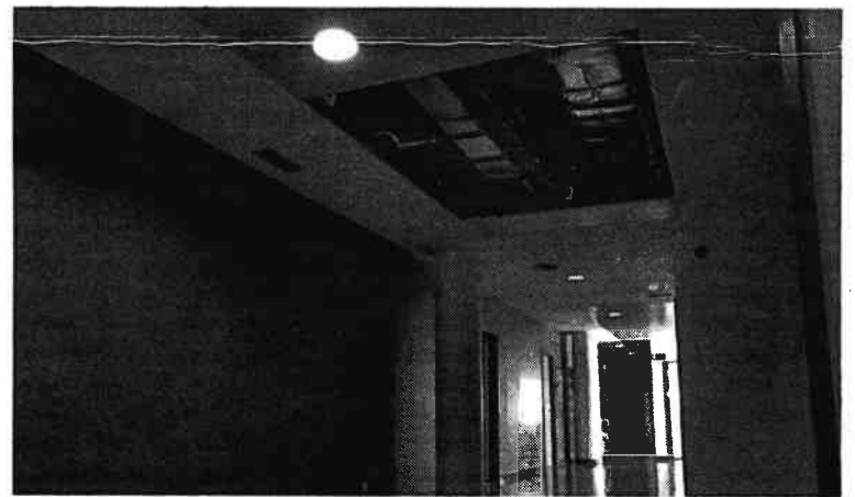
Imagen del estado del techo después de la filtración. :: F. RODRÍGUEZ
