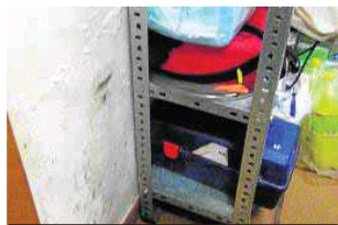
Humedades en las paredes del centro. :: IDEAL
